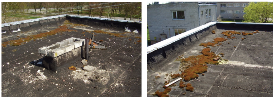
2 pav. Stogų paviršiai padengti statybinio laužu, apaugę kerpėmis, stogų dangos susiraukšlėjusios, atitrūkusios nuo pagrindo [7].
