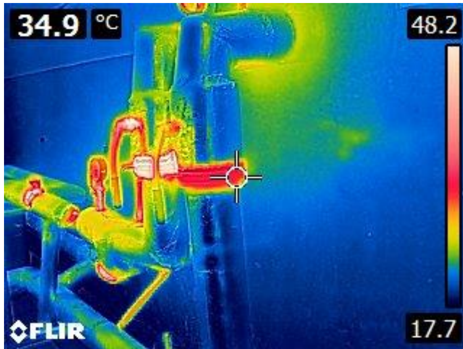
2 pav. Vamzdyno iš / į šilumos punkto į / iš karšto vandens sistemą termovaizdas Šaltinis: sudaryta autorių
